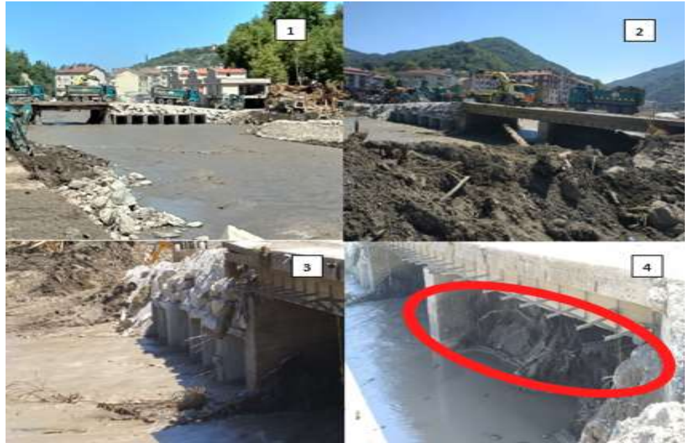
Şekil 11. Sel sonrası kısmen yıkılan 2. köprü
