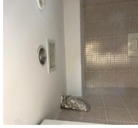
Şekil 44: Bodrum Kat Tuvaleti Kanal Çıkışı
