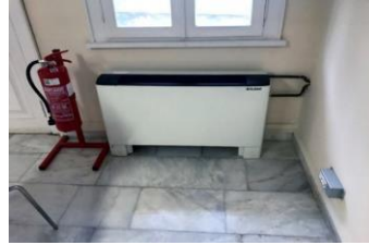
Şekil 46: Bodrum Kat Bekleme Odası (Fan-Coil)
