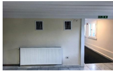
Şekil 45: Bodrum Kat Bekleme Salonu Duvardan Kanal Çıkışı
