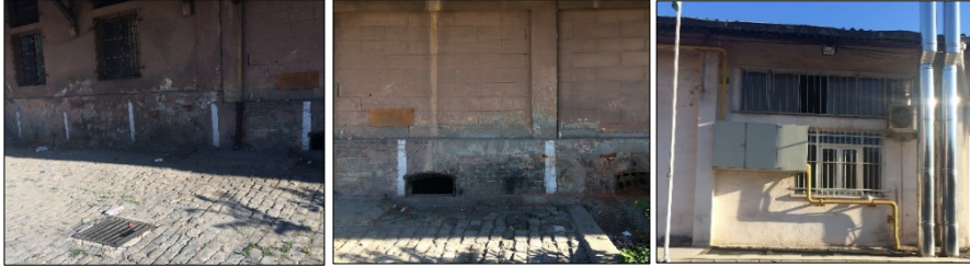
Görsel 13. Yapı bloğunun güney cephesinde görülen niteliksiz müdahaleler ve ekler (Yazar, 2020; bu görseller yazarlar tarafından çekilmiştir)
