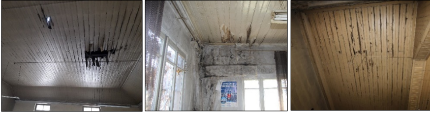
Görsel 9. Ambar binası zemin kat mahallerinde görülen malzeme bozulmaları (Yazar, 2020; bu görseller yazarlar tarafından çekilmiştir)
