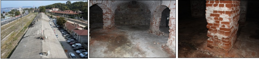
Görsel 14. Yapı bloğunda görülen strüktürel bozulmalar (Yazar, 2020; bu görseller yazarlar tarafından çekilmiştir)
