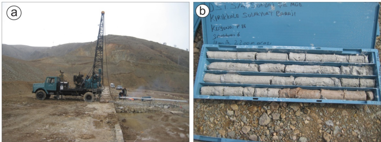
Şekil 4. Plastik beton perdede sondaj işlemi (a) ve alınan karotlar (b) (Foto: A.Apaydın).
