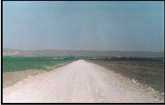
Şekil 2- Karaali Köyünü Akçakale-Şanlıurfa Karayoluna Bağlayan Bozuk Yol.
