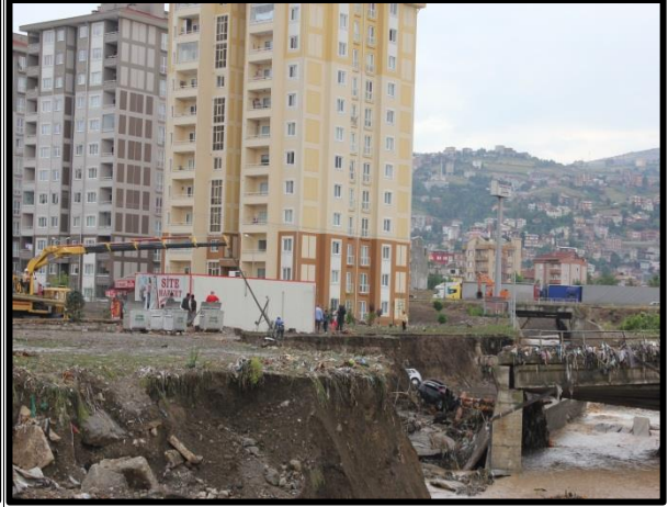
Şekil 10a: Yılanlı Dere'nin taşkın sonrasındaki görünümü. Yıkılan köprü, hasar gören ve vadiye düşen otomobiller.
