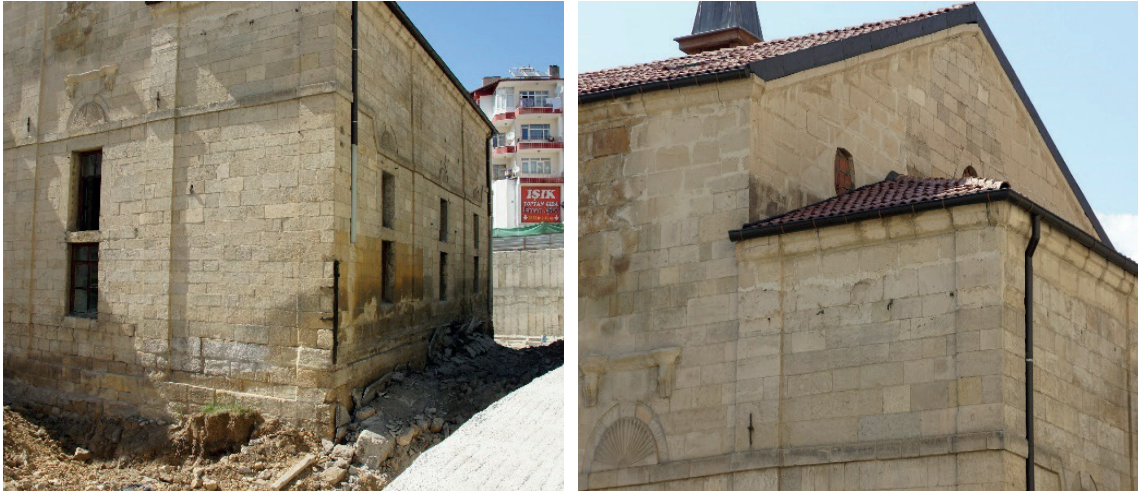
Şekil 16: (a) Restorasyon Sırasında Yapılan Araştırma Kazısı ve (b) Çatı Sökülüp İçeride Sıva Raspaşı Yapılınca Ortaya Çıkan Yuvarlak Tepe Pencereleri (2018)
