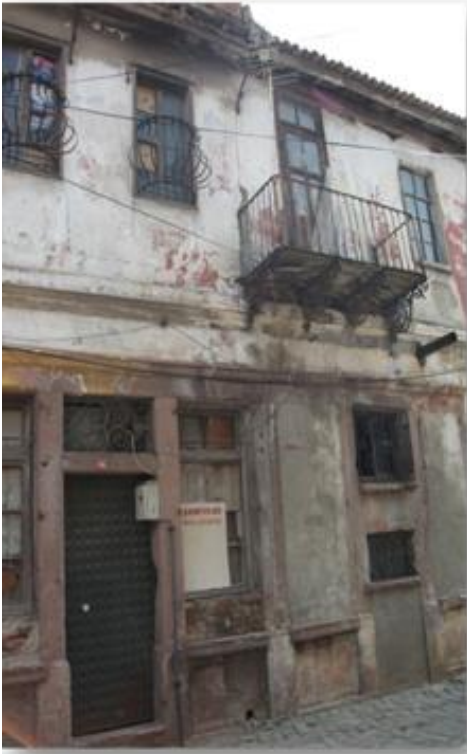
Şekil 14 Kötü işçilik ve yanlış detaylandırma (malzeme bazında bozulmalar) (Yazar arşivi, 2010)
