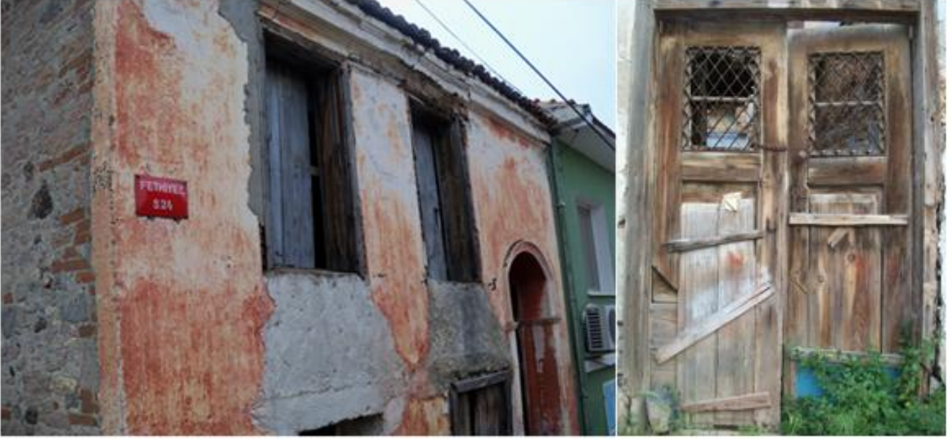
Şekil 13. Duvarlarda, kapı ve pencerelerde bozulan ve dağılan yüzeyin eskisiyle özdeş olmayan malzemelerle tamamlanması (Yazar arşivi, 2010)
