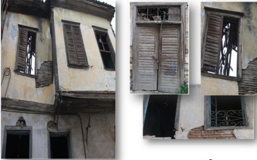
Şekil 7. Zemin karakteristiğinin neden olduğu yapısal bozulmalar ve kapı boşluğundaki açılmalar (Yazar arşivi, 2010)
