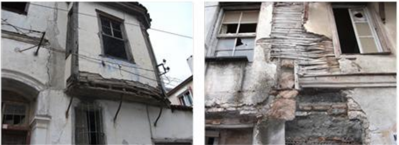
Şekil 9. Sıva dökülmeleri ve derz aralarının boşalması (malzeme bazında bozulmalar) (Yazar arşivi, 2010)
