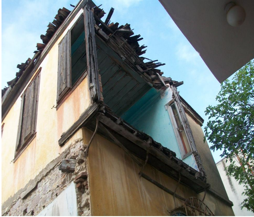
Şekil 12. Hasar görmüş çatı (malzeme bazında bozulmalar) (Yazar arşivi, 2010)
