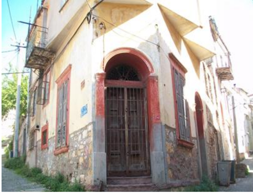
Şekil 10. Zemininden su almış duvar resimleri(malzeme bazında bozulmalar) (Yazar arşivi, 2010)
