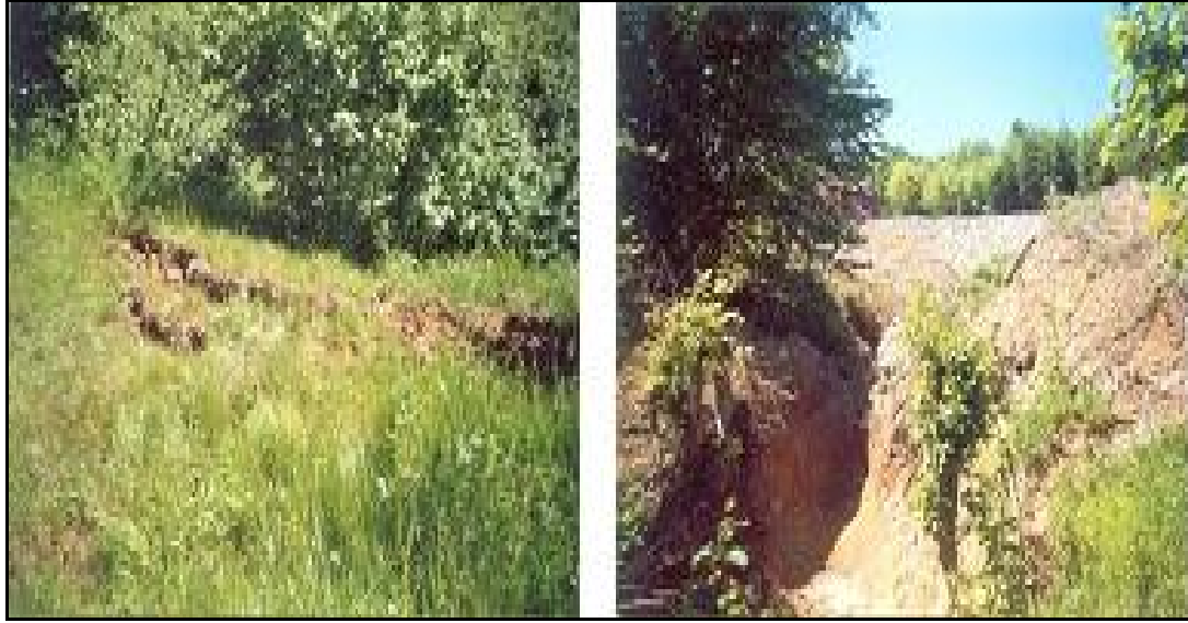
Şekil 4. Karacangaç Tepe kaymasıyla oluşan gerilme çatlakları ve çökme.
