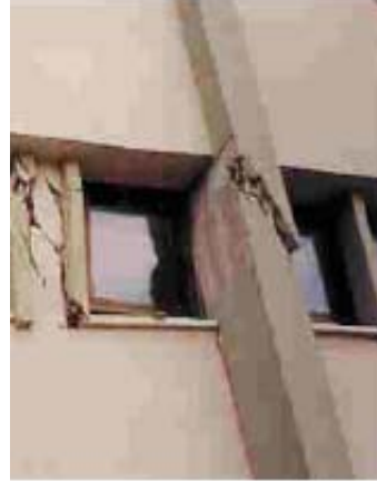
Şekil3. Bir kısa kolon hasarı [19].
