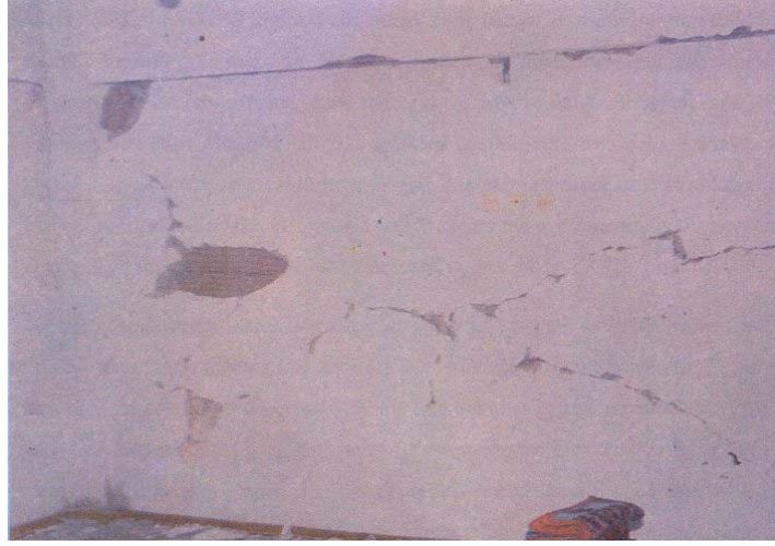
Şekil 1. Tuğla duvarda hasara bir örnek.
