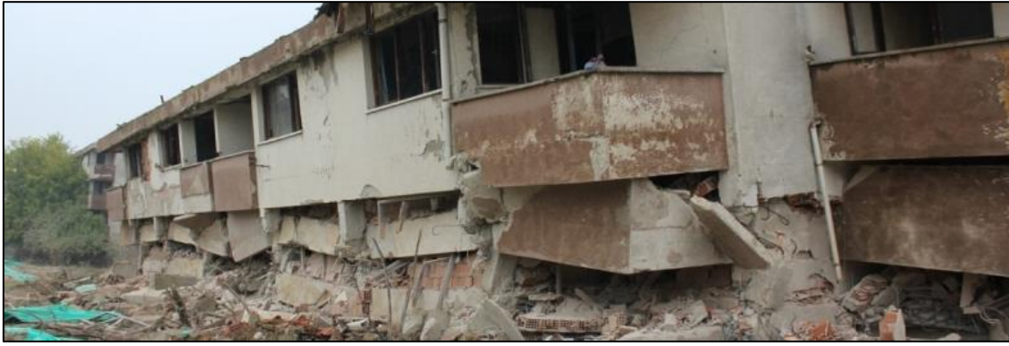
Şekil 17: Binanın Enkazı (Özyurt, 2013)
