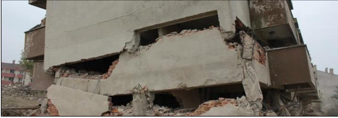
Şekil 16: Binanın Enkazı (Özyurt, 2013)
