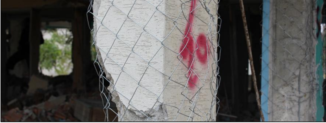
Şekil 13: Kolonlarda Uygulanan Güvenlik Önlemleri
