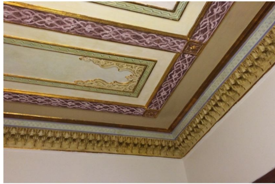
Fotoğraf 14 Zemin Kat Z07 Numaralı Odanın Tavan Silmesi
