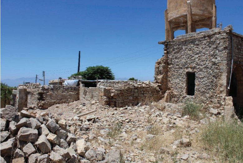
Resim 1: Avlu Güney Bölümündeki Yıkıntı Duvar İzleri
