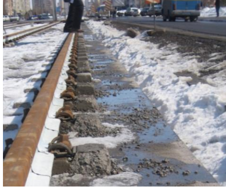
Şekil 2. Traverslerde buz çözücülerden kaynaklanan çatlama ve bozulmalar
