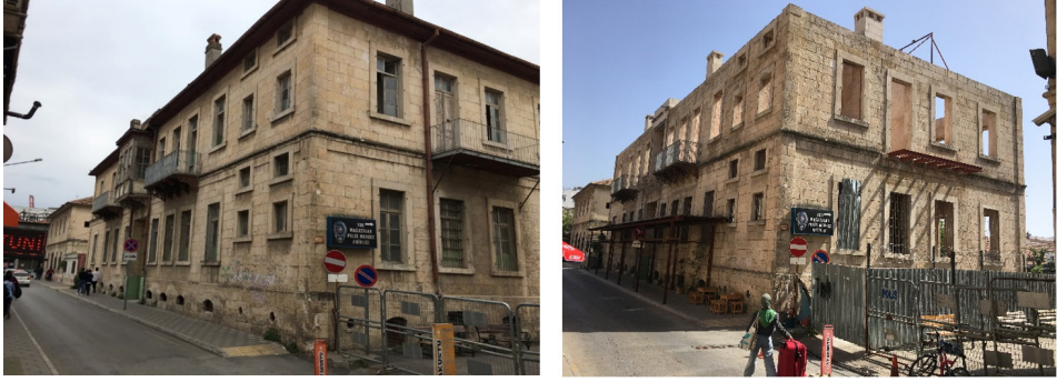
Görsel 9: Eski 3 Ocak İlköğretim Okulu - Restorasyon öncesi (Adana VBM Arşivi, 2017) ve restorasyon sırasındaki görünümü (2022)
