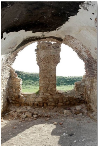
Görsel 9: Tabya ön hücre dış duvarın içten görünümü (öncesi).
