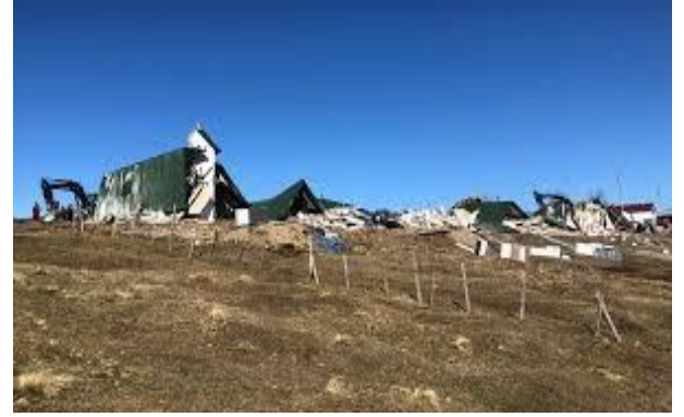
Şekil 4. Meralardaki inşaatların yıkım (Anonim, 2022d) Figure 4. Destructions in pastures (Anonymous, 2022d)
