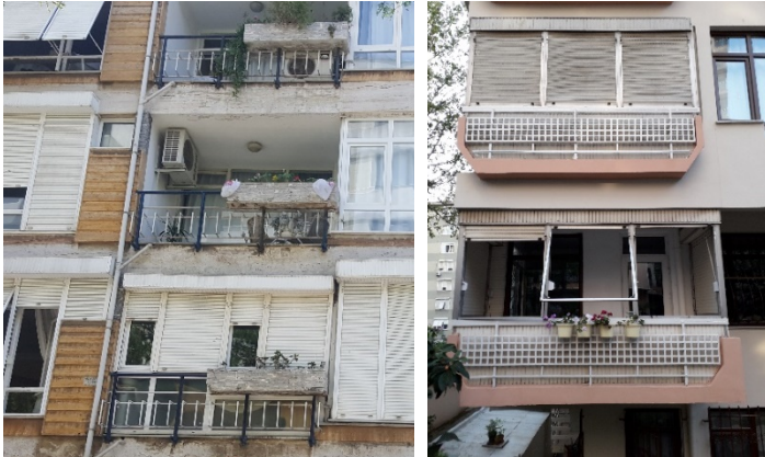
Şekil 6a ve 6b. Çizgisel ve düzlemsel korkulukların bir arada kullanımına örnekler (sıra-sıyla); Beylerbeyi Apartmanı (Muammer Gerekli, 1956, Göztepe) ve Ursa-Celiloğlu Apartmanı (Atay AliYazıcıoğlu, 1970'ler, Fenerbahçe) (Kaynak: Yazarların arşivi)
