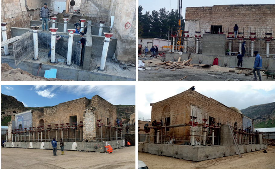
Görsel 16: Kızlar (Eyyubi) Camii Batı ve Doğu Bloğu Strüktürel Bütüncül Taşıma Projesi Kaldırma Kriko Sisteminin Kurulması (KVMGM ve DSİ arşivi).
