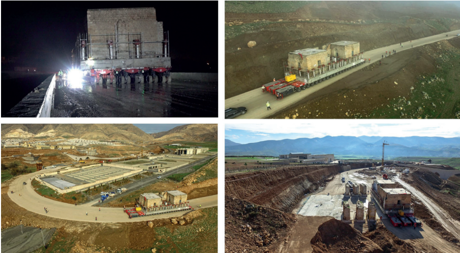
Görsel 18: Kızlar (Eyyubi) Camii Batı Bloğu Strüktürel Bütüncül Taşıma Projesi Kapsamında 24 Akslı 3 Sıradan (Toplam 72 Aks) Oluşan SPTM Taşıyıcı Platform Üzerinde Arkeopark Alanındaki Yeni Konumuna Taşınması (KVMGM ve DSİ arşivi).
