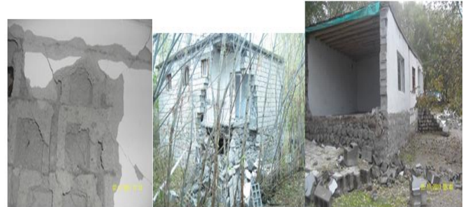
Şekil 2. Tipik Duvar Hasarları [6],[7]
