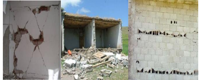
Şekil 1. Tipik Duvar Hasarları [7]
