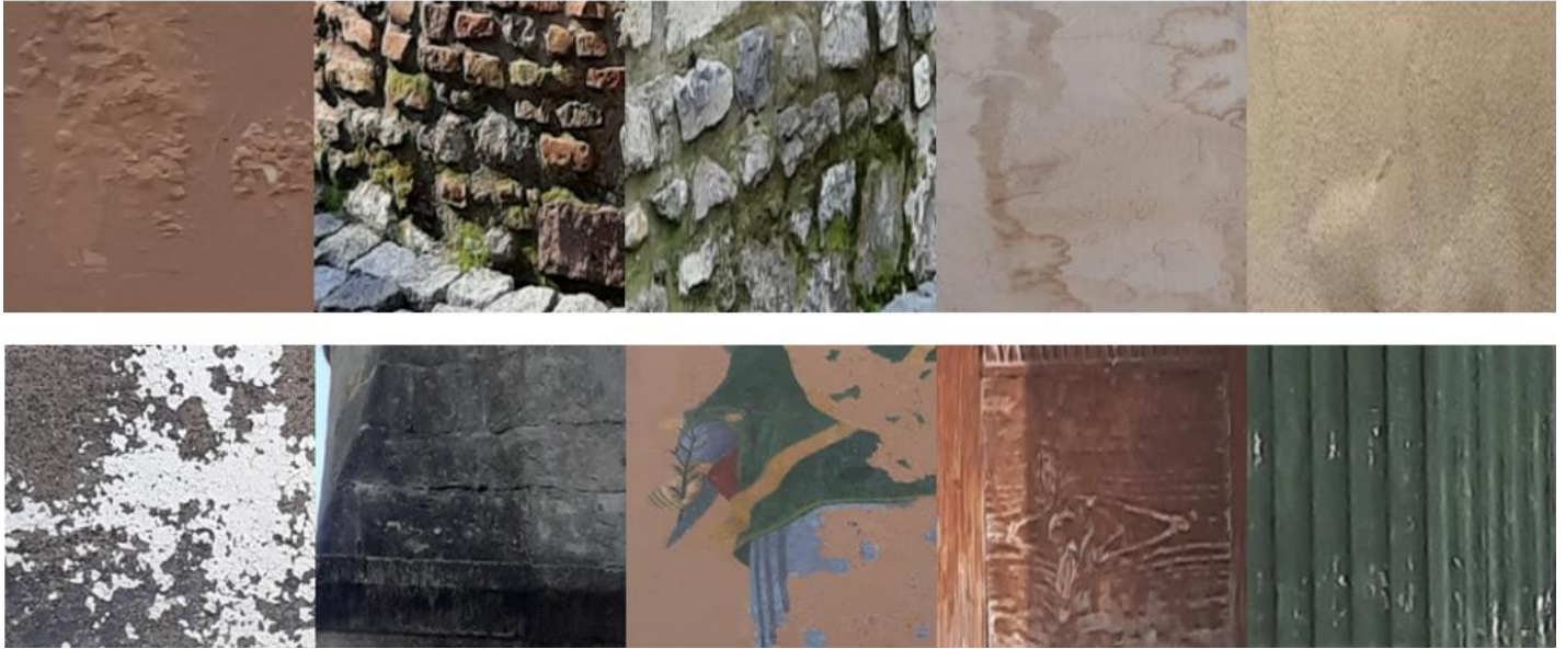
Şekil 1. Yapılarda Bazı Nem Hasarları ve Bozulmalar
