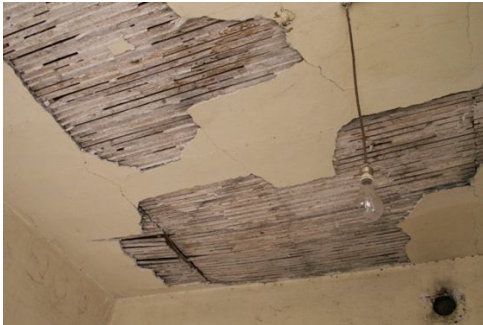
Resim 13. Babaeski Gar Binası Birinci Kat Döşemesi
