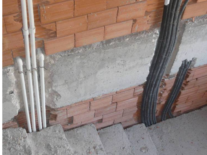
Şekil 1. Elektrik ve su tesisatçıların BA sisteme verdiği zarar
