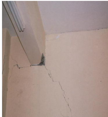
Şekil 12. Kirişin yakın mesafedeki kolona mesnetlenmeyip, kirişe saplanması sonucu oluşan çatlamlar
