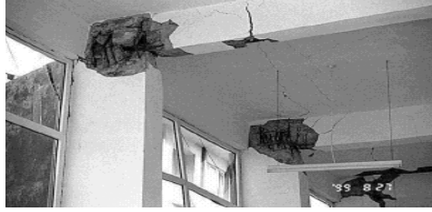
Şekil 3. Düğüm noktasında mafsallaşma ve kirişte eğilme çatlakları [3]
