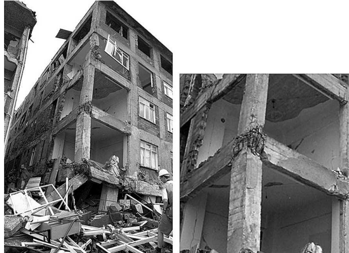
Şekil 10. Kolon-kiriş birleşim yeri hasarı [3]
