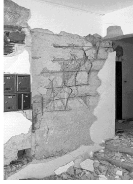
Şekil 14. Perdede meydana gelen kesme hasarı [3]
