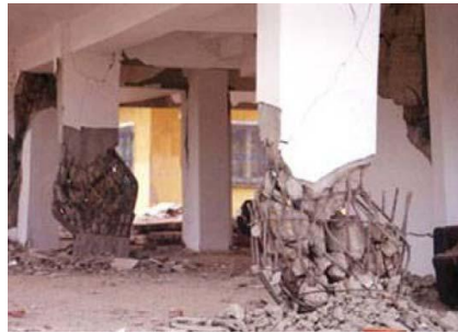
Şekil 8. Kolonda burkulma hasarı [7]
