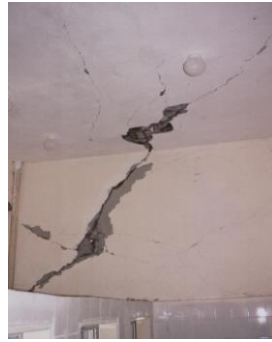
Şekil 13. Duvarda kesme çatlağı ve döşemede sürekliliği
