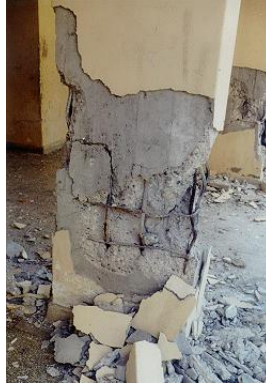
Şekil 7. Kesme ve eğilme etkisiyle meydana gelen kolon hasarı [6]
