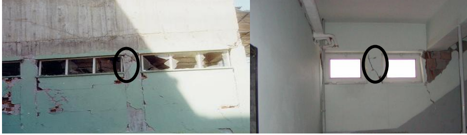
Şekil 9. Zemin katta perdeden kolona geçerken kısa kolon hasarı [5,6]
