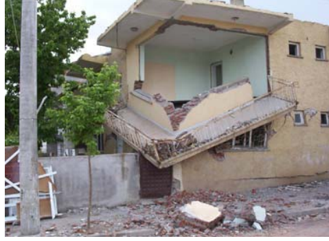
Şekil 8. Yığma yapıda ön cephedeki boşluktan kaynaklanan hasar [4]
