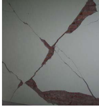
Şekil 4. Yığma duvarda oluşan tipik kesme çatlakları [4]
