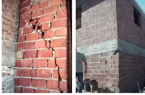
Şekil 3. Yığma yapıda oluşan duvar hasarları [1]
