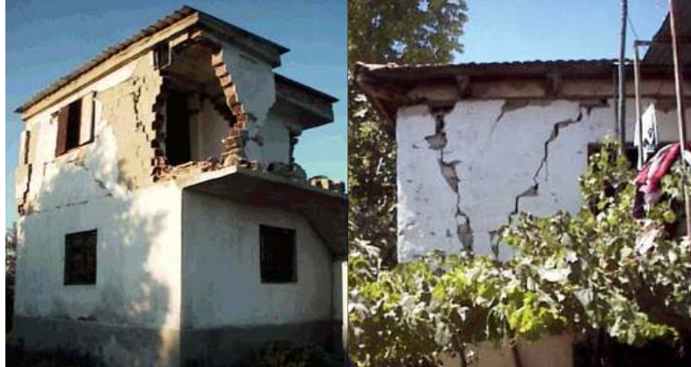
Şekil 2. Yığma yapılarda görülen farklı hasarlar [2]
