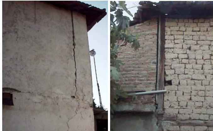
Şekil 5. Yatay ötelenmeden dolayı köşe noktalarda oluşan ayrışmalar [1]
