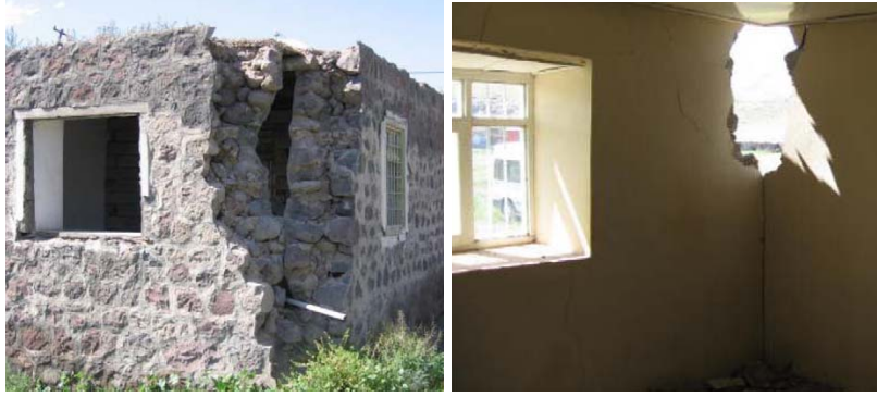
Şekil 6. Yığma yapılarda birleşim bölgelerinde oluşan ağır hasarlar [6]
