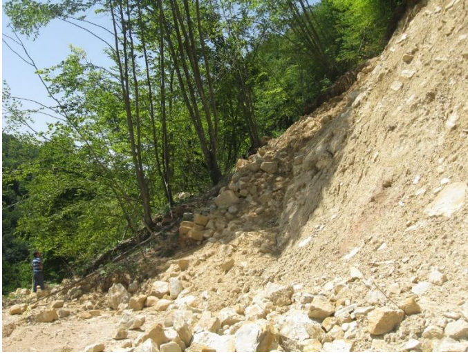
Şekil 1. Büyük onarım ihtiyacı olan bir orman yolu.
