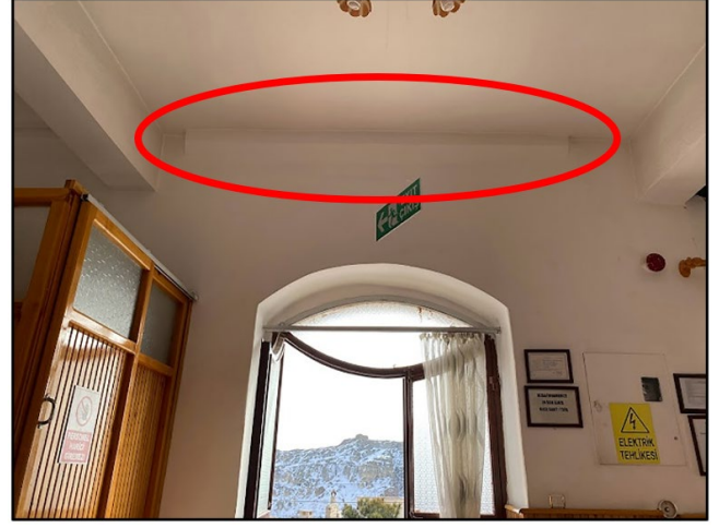
Şekil 18. Yapıda Kesilerek Özgünlüğü Bozulan Silmeler, Ürgüp, 2022.
