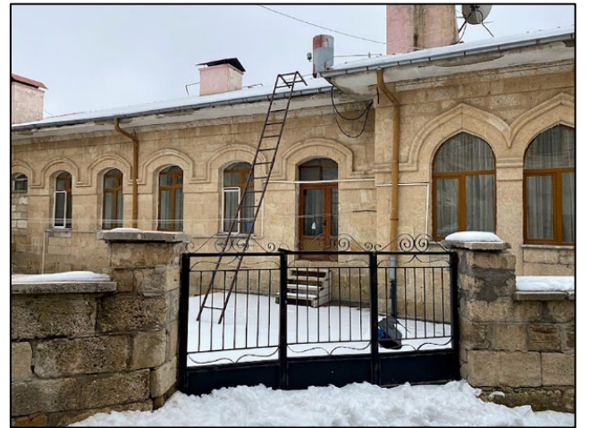
Şekil 14. Yapının Arka Cephesinde Kapatılan Pencereler, Ürgüp, 2022.
