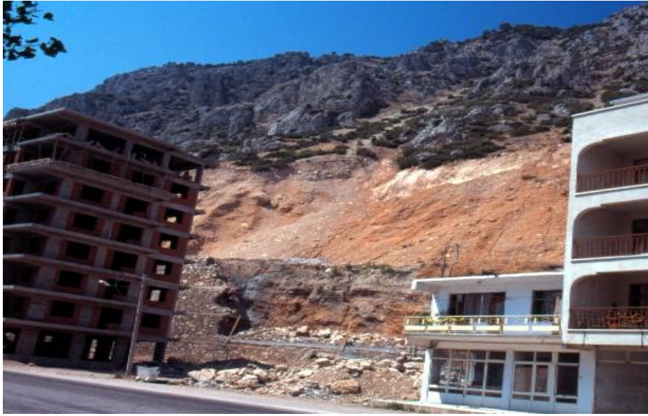
Foto-1. Eğridir Sivritepe eteğindeki birikinti konisinin ortadan kaldırılmasıyla oluşturulan konut alanında, daha binaların karkaslarının yapımı sırasında, Sivri Tepe'den taş düşmesi sonucu ihata duvarının yıkılması.
