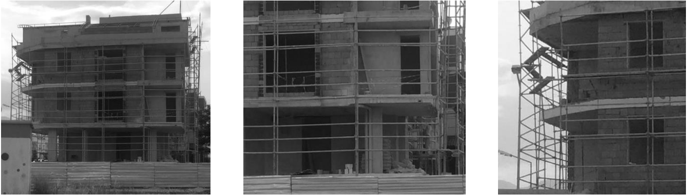
Şekil 5. Dış cephe iş iskelesi örneği-2 (Orijinal)
