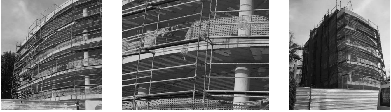
Şekil 4. Dış cephe iş iskelesi örneği-1 (Orijinal)
