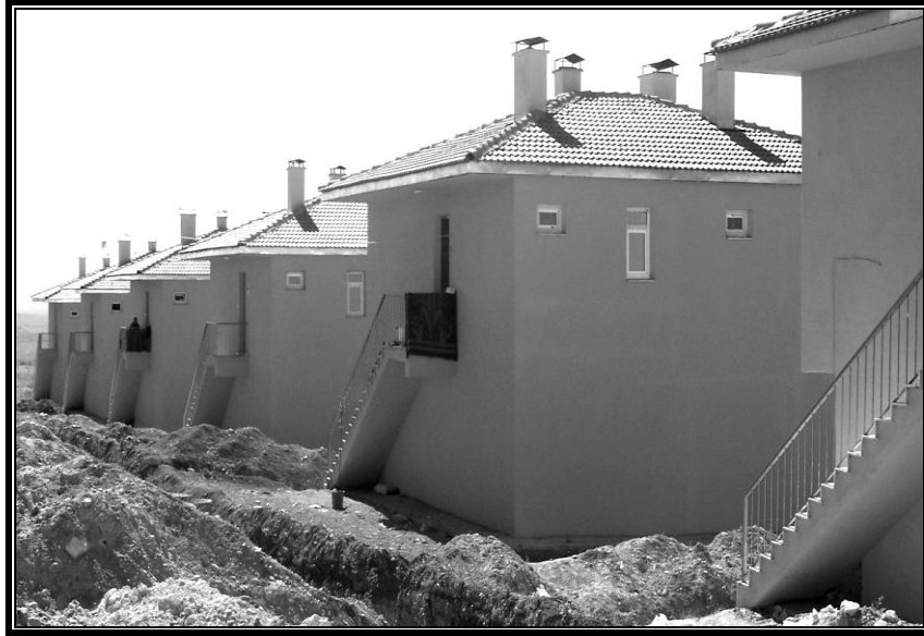
Fotoğraf 2. Paşayurdu köyünün yeni yerleşim yerinde; kanalizasyon, su, elektrik ve telefon hattının birlikte olduğu kanal.
