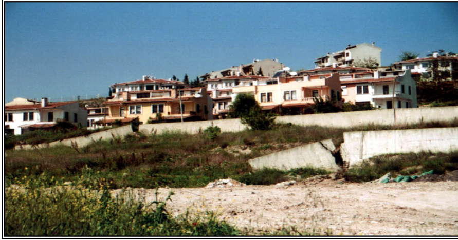
Foto 1: Gürpınar batısında heyelandan zarar görmüş istinat duvarları.
