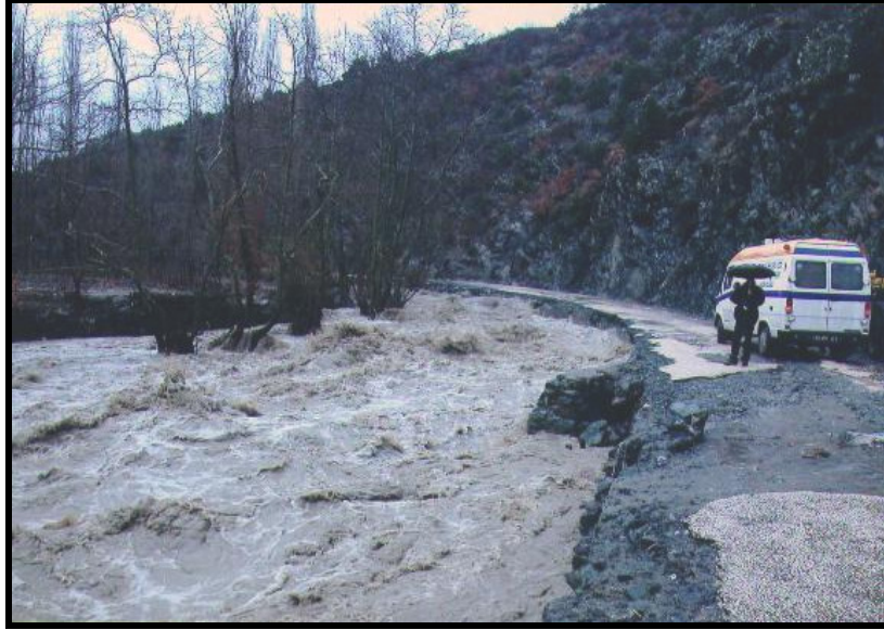
Fotoğraf 3. Sel, Turhal şehrini Çamlıca Köyü'ne bağlayan asfalt yolun da tahribine yol açmıştır.
