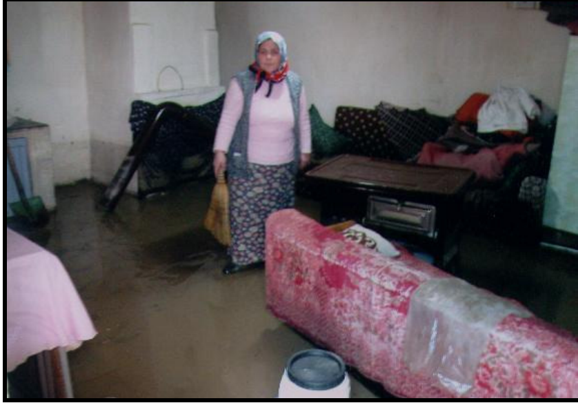
Fotoğraf 1. Borsa Mahallesi'nde sel sularının istilasına uğramış bir meskenin oturma odası ve selden zarar gören eşyalar.
