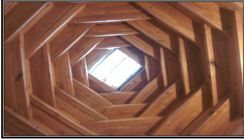
Fotoğraf 4. Harçlı Köyünde Abdulvahap Yavuz'a ait meskende kırlangıç örtü olarak adlandırılan baca.
