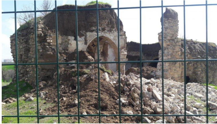
Şekil 7. Kısmi yıkılma sonrası kuzeybatı cephesi (URL-6, 2022).
