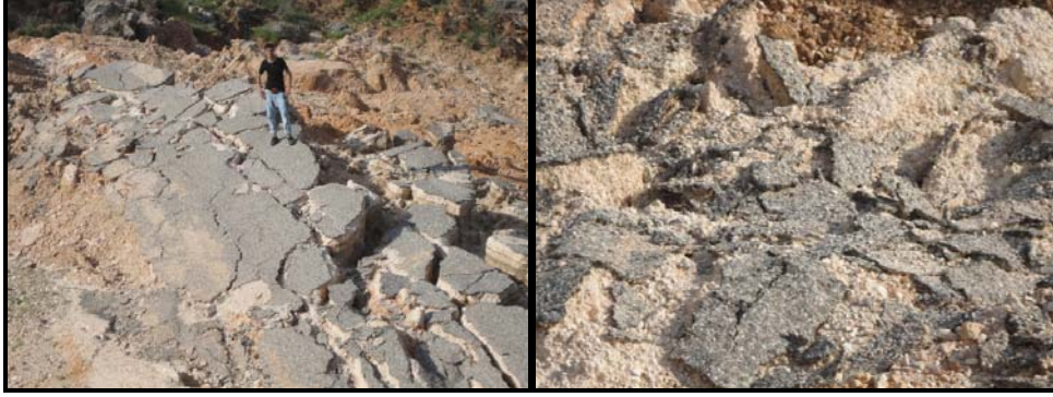
Foto 8: Asfalt yolun heyelan sonrası durumu.
