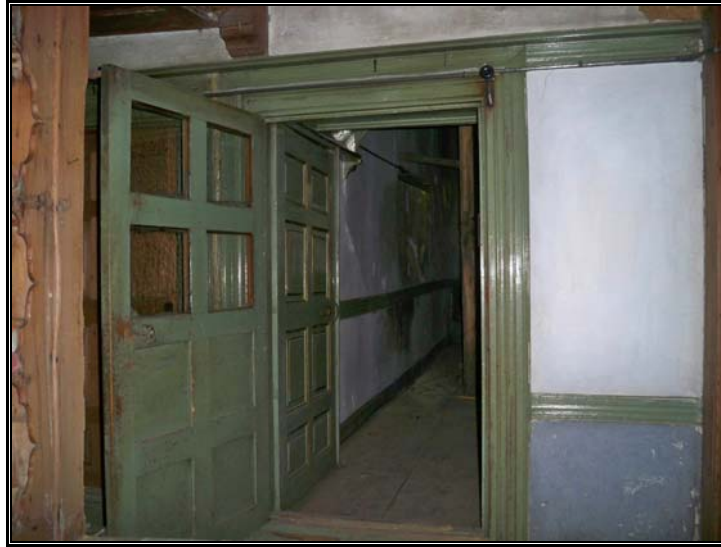
Fotoğraf 8: Somunoğlu Evi'nde Tandirevinden Geçiş Yapılan Haremlik Odasının Giriş Kapısı . Sıcaklık muhafazası için çift kanatlı olarak inşa edilmiştir.
