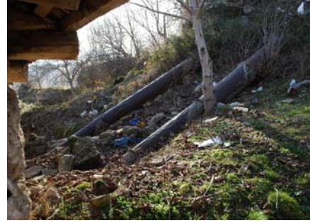
Fotoğraf 6. Savak ile çark arasında yer alan ve yaklaşık kırk beş derece eğimle yerleştirilmiş olan cebri borulardan bir görünüş.
