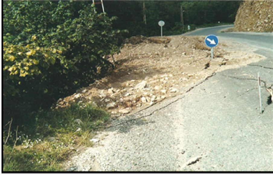
Foto 1.Çalışma sahasında sel ve taşkınların sebep olduğu yol bozulmaları.
