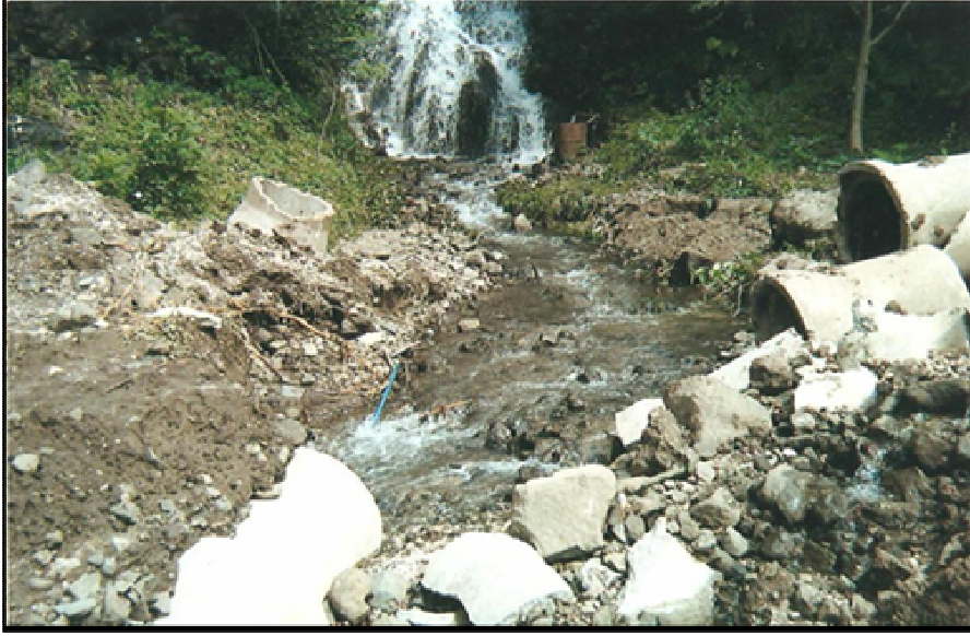
Foto 3. Sel ve taşkınlardan tahrip olmuş kanalizasyon şebekeleri (Fatsa, Sakarya Mahallesi)
