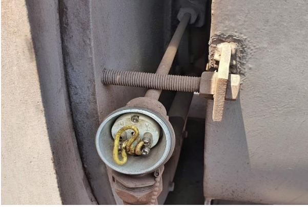
Şekil 4. Motor rulman yatak sıcaklığı sensörünün metal koruması ve terminal bağlantı kutusu ile sahadaki uygulaması
