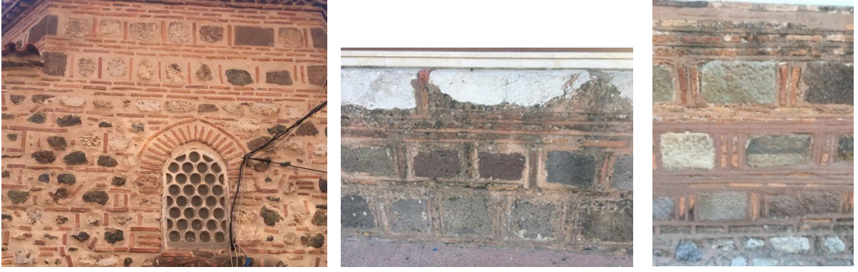
Şekil 48. Hatuniye Camisi sağ yan penceresi , 2022. Şekil 49-50. Duvar örgülerinde bozulmalar, 2022.
