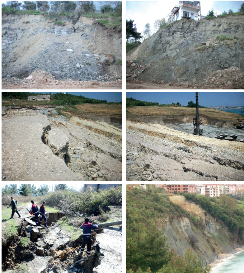
Şekil 7. Karadeniz sahil yolu yapımı aşamasında meydana gelen heyelanlara ait görüntüler. Figure 7. Landslides occurred during the construction of the Blacksea coastal road.
