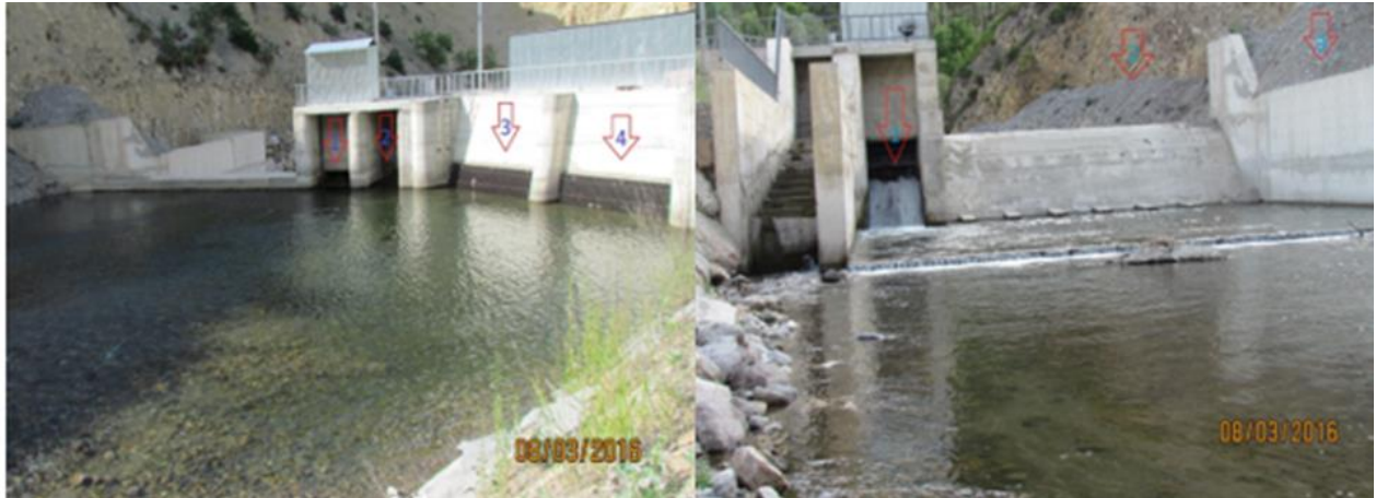
Fotoğraf 2. Regülatör Yapısının Önünde Biriken Sedimanların Vadi Yamaçlarına Depolanması Sonucu Oluşan Çevre Kirliliği
