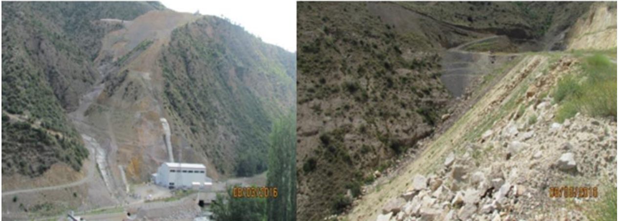
Fotoğraf 1. HES Ünitelerinin İnşası Aşamasında Bitki Örtüsünün Tahrip Edilmesi ve Yamaçlardan Dökülen Molozların Oluşturduğu Çevre Sorunları
