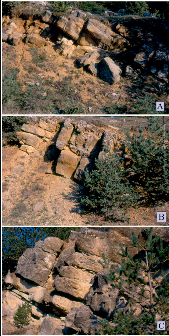
Şekil 15- Akgöl Formasyonu'nun türbiditik kumtaşı (A), çakıllı kumtaşı (B), çakıl-iri çakıl bloklu kumtaşı (C) tabakaları.
