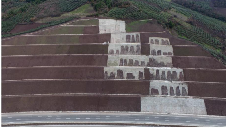
Şekil 4. Yarma şevlerinde taş dolguda gözlemlenen deformasyonlar
