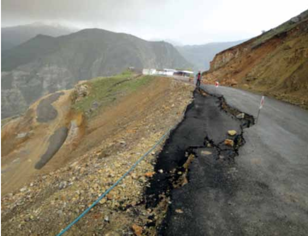
Şekil 31. Pervari kuzeybatısında mevcut yolda 2010 yılı Nisan ayında oluşan heyelan ve çatlakları. Yeni gelişen heyelan Siirt-Pervari ana yoluna zarar vermiştir.
