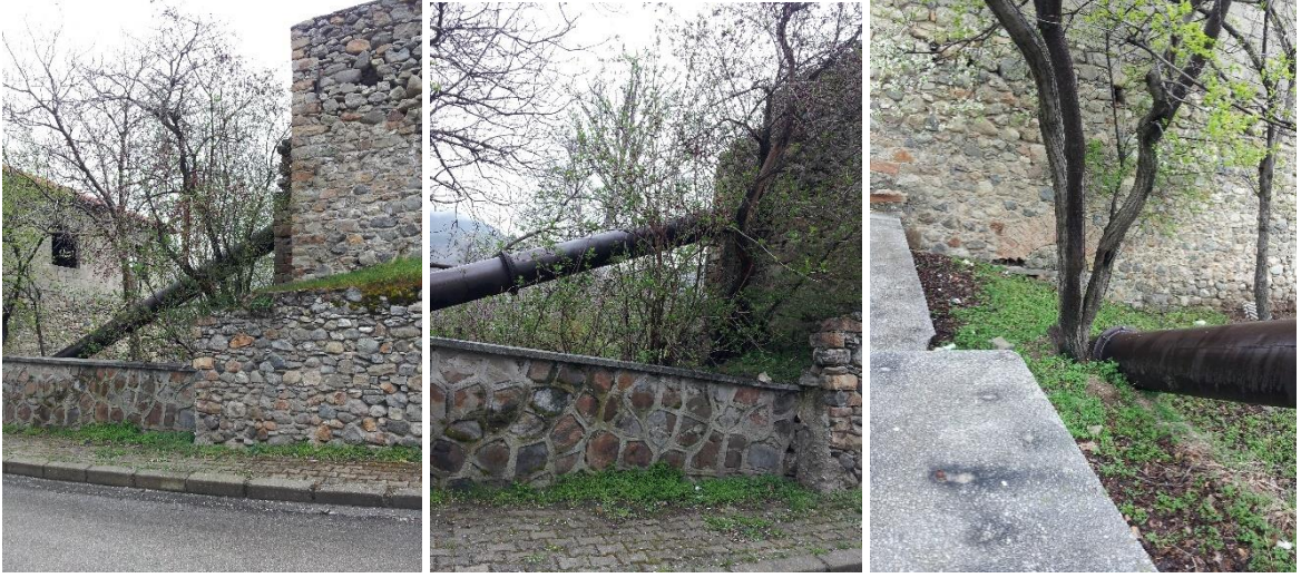
Resim 27. Depodan suyu hızla tahliye eden metal boru (Gökarıslan ve Köse arşivi, 2022)
