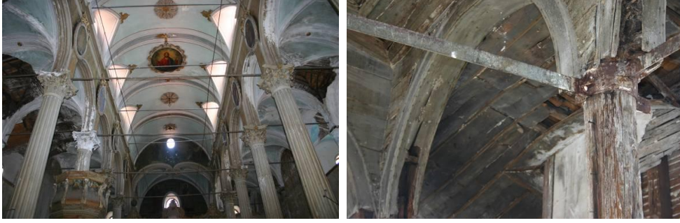
Foto 4 – Taksiarhis kilisesi (sol) ve Hagios İoannes Kilisesi (sağ) gergi demirleri
