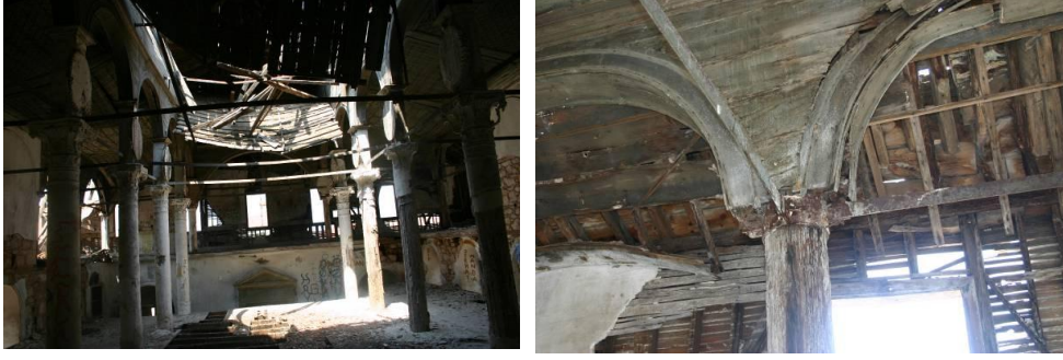
Foto 5 – Hagia Triada Kilisesi gergi demirleri (sol) ve gergi demirlerinin sütunla birleşim detayı (sağ)
