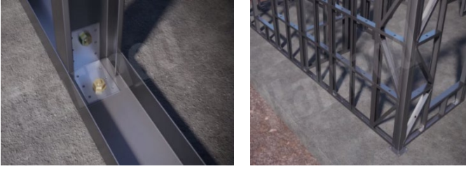
Şekil 17. Orta dikmelerin sabitlenmesi-Sistemin görünümü (Fixing the middle struts- the appearance of the system) (Karmod Prefabrik Yapı, 2021)
