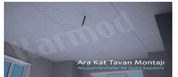
Şekil 42. Zemin kat tavanına alçıpanın montajı (Installation of drywall on the ground floor ceiling) (Karmod Prefabrik Yapı, 2021)
