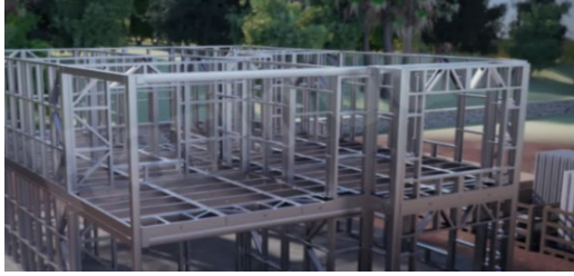
Şekil 24. 1.kat duvar montajı sonrası genel görünüm (general view of the system after first floor wall installation) (Karmod Prefabrik Yapı, 2021)
