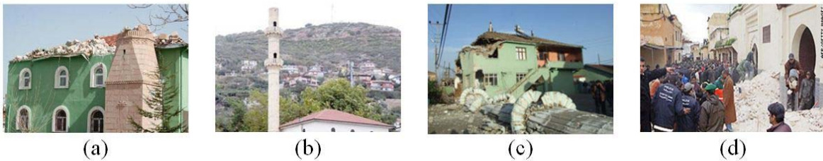
Şekil 2. Fırtınalar nedeniyle yıkılmış bazı minareler (a)13 Mart 2013 Aksaray (b) 21 Ekim 2012 Alanya (c) 18 Aralık 2010 Samsun (Bafra) (d) 20 Şubat 2010 Fas (Destroyed some minarets due to the hurricanes)
