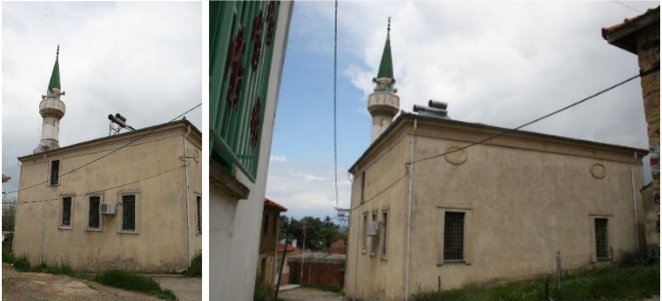
Şekil 8. Sıvalı batı ve güney cephe. Çatıda su sistemi, duvarda klima ünitesi 2019.
